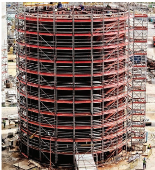
Elektrownia Jaworzno / Jaworzno Power Plant
